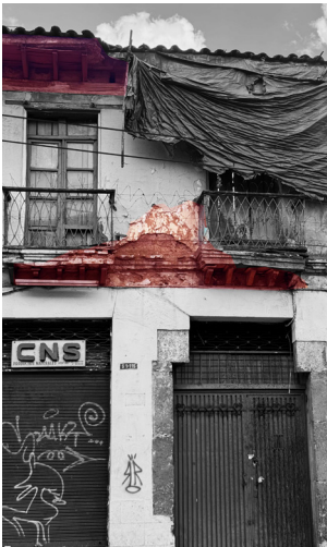
Imagen 4: Inmueble en deterioro y desuso en la Avenida Pedro Vicente Maldonado Fuente: Elaboración propia, 2026.
