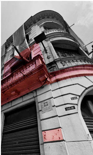
Imagen 5: Inmueble en deterioro en la Vargas y Manabí Fuente: Google maps, s/f.
