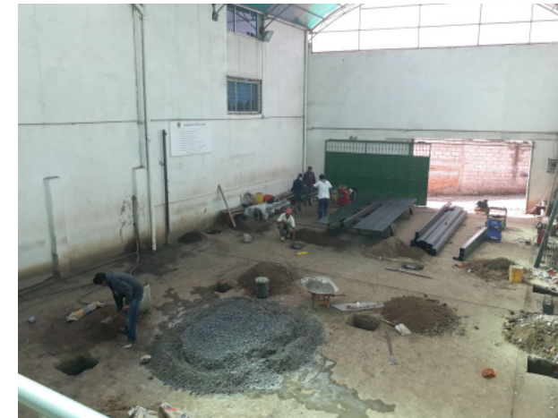
Ilustración 5. Intervención cimientos en cancha para plataforma del gimnasio (Fotografía de autoría propia)
