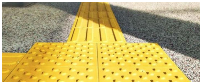
Figura 13: Pavimento podotáctil Fuente: Artser,2024
