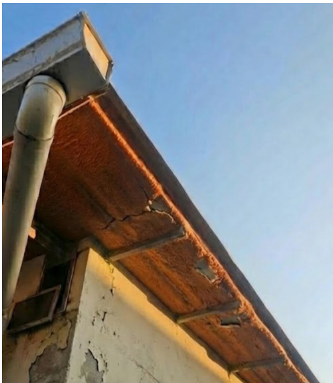
Imagen 12. Deterioro de la fachada por fisuras, humedad y desprendimiento de revestimientos
