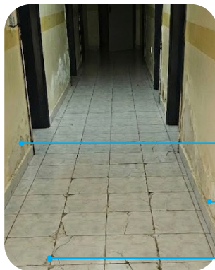
Fisuras en el revestimiento del piso
