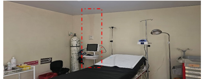
Imagen 6. Presencia de humedad en la zona de emergencia del "Hospital Básico de Amaluzza".
