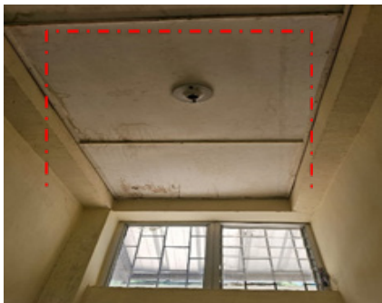
Imagen 4. Techo interior de madera en el cielo raso con manchas.
