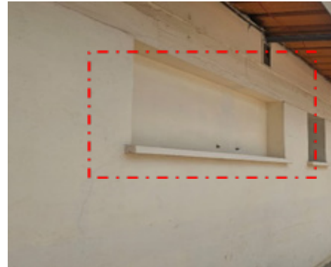
Imagen 7. Espacios que deberían tener ventanas se evidencian tapados.
