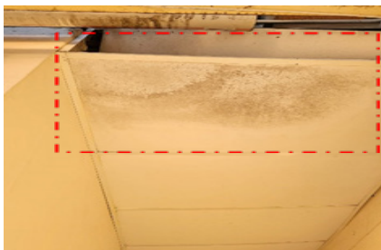
Imagen 5. Techo exterior de PVC en el cielo raso con manchas.
