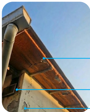
Desprendimiento de acabado en muro y desprendimiento del aislante del techo
