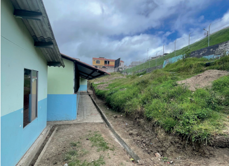
Figura 114. Pendiente sin tratar 2024
