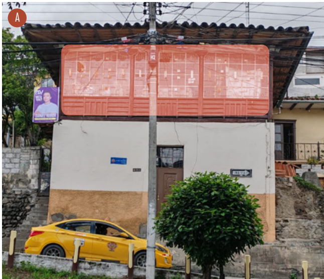
Figura 59 Estado actual de elemento balcón
