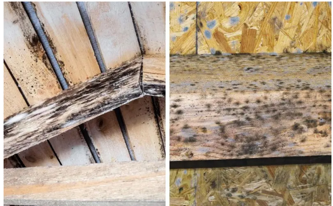
Patologías en cielos rasos madera
