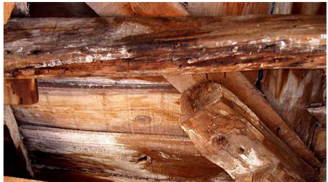
Figura 25. Patologías en cielos rasos madera
