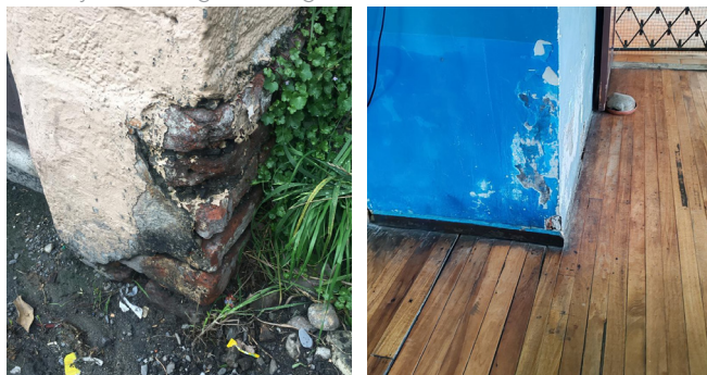
Figura 56. Pilares y muros cargueros originales afectados
