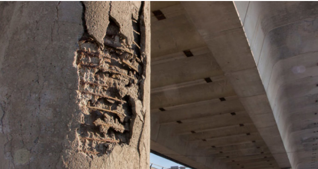
Figura 12. Lesión física, erosión física del hormigón
