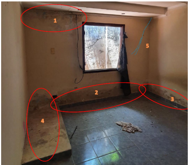
Figura 10 Patologías de la edificación
