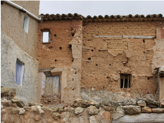
Figura 19. Proyecto con patologías en muros de tapial
