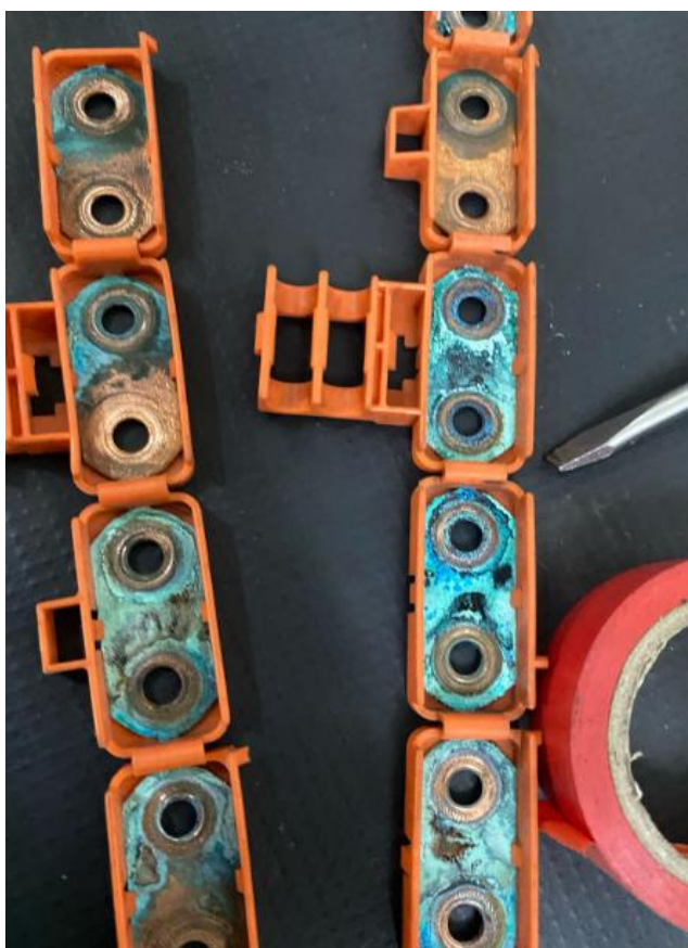
Anexo 17. Placas de conexión de cobre después de lavado por ultra sonido
