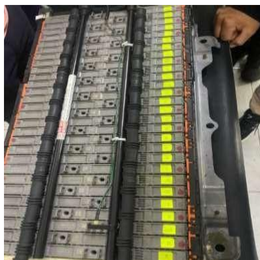
Figura 11: Visualizaciones de la parte eléctrica
