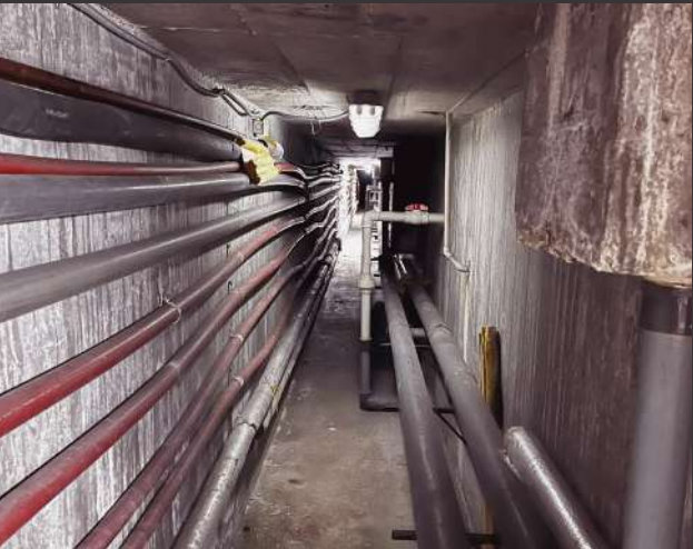
Imagen 57. Pasillo de Instalaciones Hidrosanitarias Fuente y Editado por el Autor, 2024
