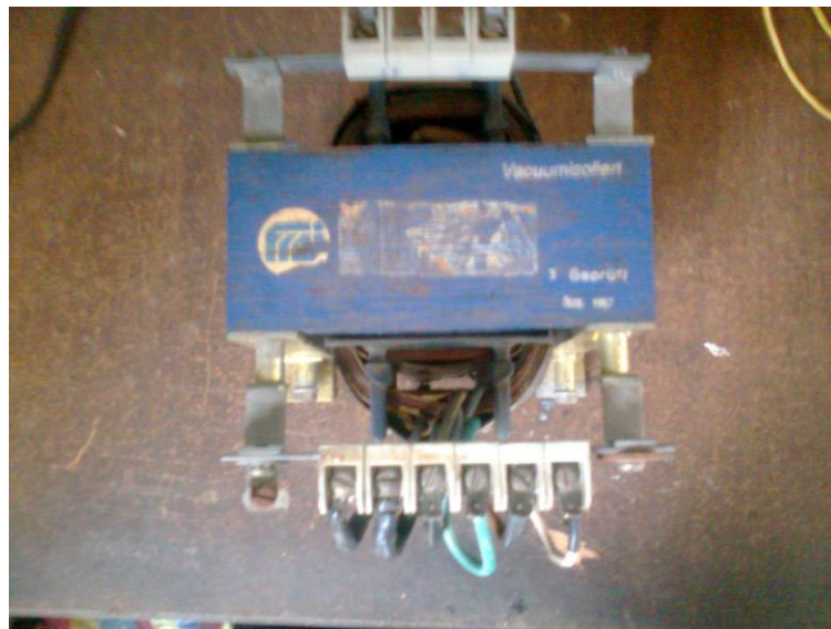
Figura 3.2. Transformador. Fuente: Fotografía propia
