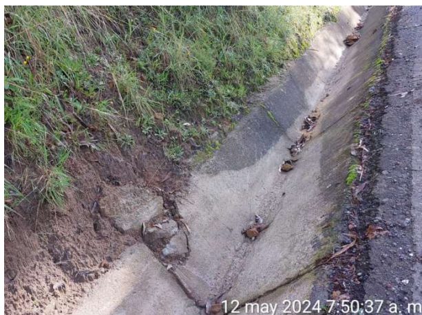
Imagen 4 Desprendimiento en cuneta
