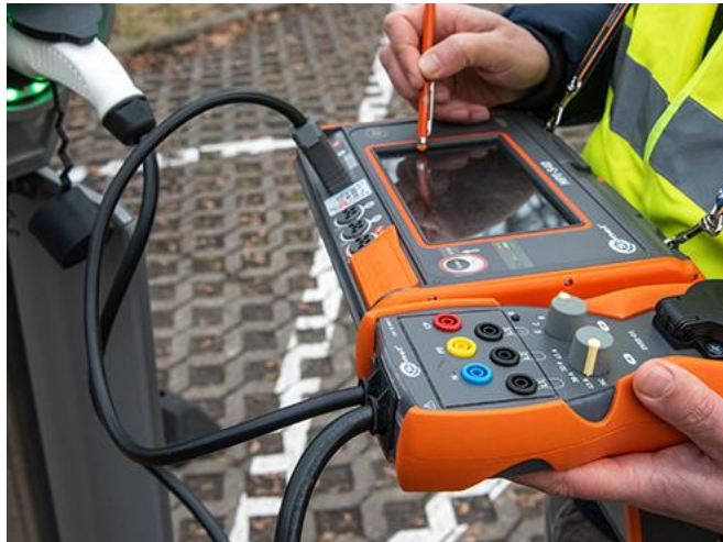
Mediciones de seguridad antes de cargar un vehículo eléctrico
