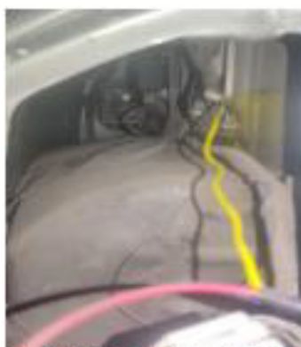
Ingreso del cable de señal dentro de la cabina por el lateral posterior
