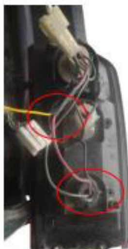
Salida de cableado foco de luces medias y freno y empalme cable señal de encendido
