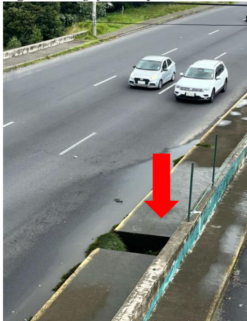
Figura 69 Agujero en parterre central
