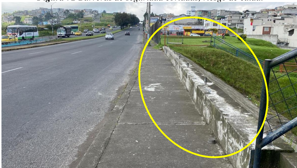
Figura 72 Barreras de seguridad cortadas, riesgo de caída.
