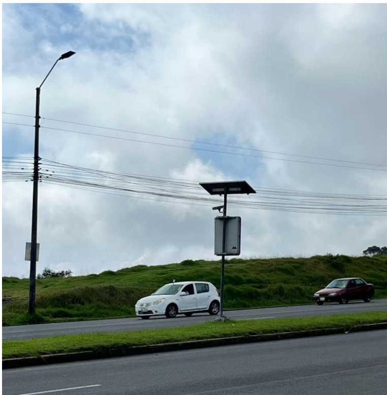
Figura 66 Radar de velocidad en la Avenida Simón Bolívar tramo La Argelia
