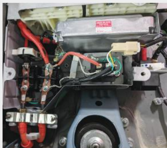
Cable de estructura y relés principales del sistema
