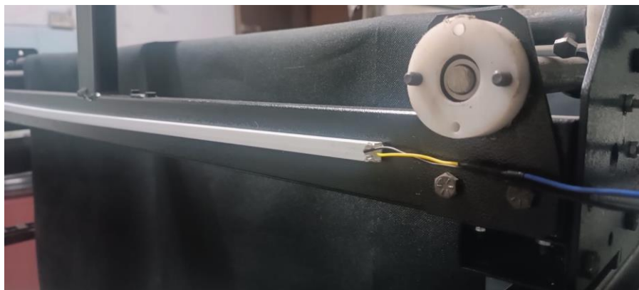
Figura 5. Fotografía de la canaleta plástica del cableado de control del sistema. Véase que esta parte no presenta, ni debe presentar, ningún cable salido de su hendidura.
