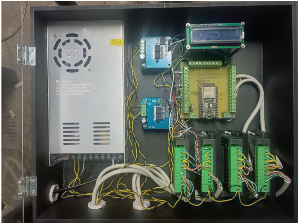
Figura 8. Fotografía de la caja de control del sistema prototipo junto a todos sus elementos eléctricos y electrónicos pasivos previo a su encendido y puesta en marcha.
