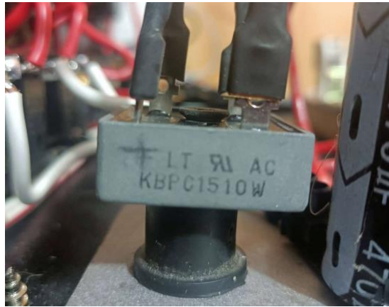
Ilustración 28 instalación del circuito a retificar
