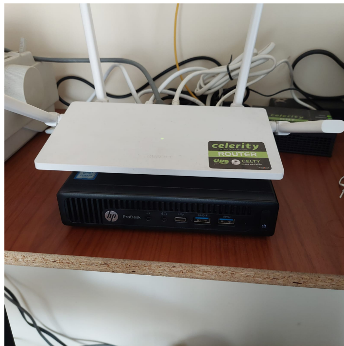
Figura 82. Instalación servidor nuc.
