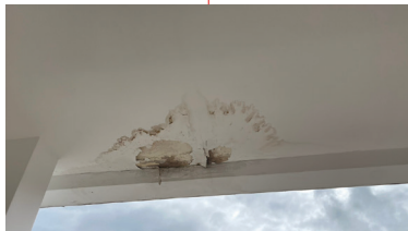
Daños internos debido a humedad.
