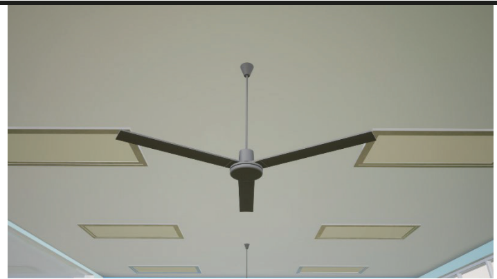
Ventiladores de techo | Humedad relativa: 50%
