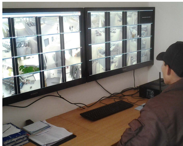
Figura 104. Sala de monitoreo de seguridad.
