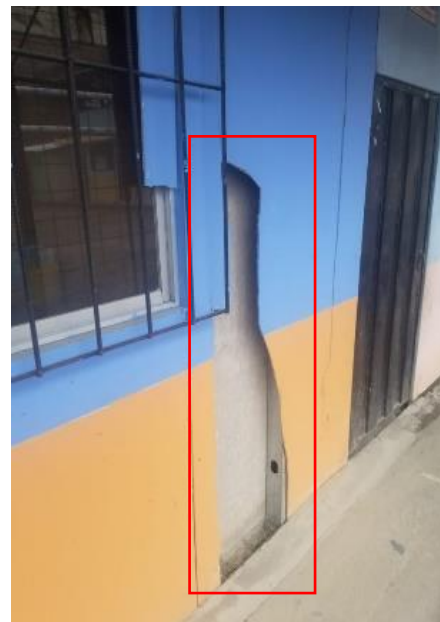
Ilustración 4. Identificación de patología de deterioro de bloque prefabricado
