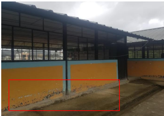
Ilustración 3. Identificación de patología de humedad en fachada
