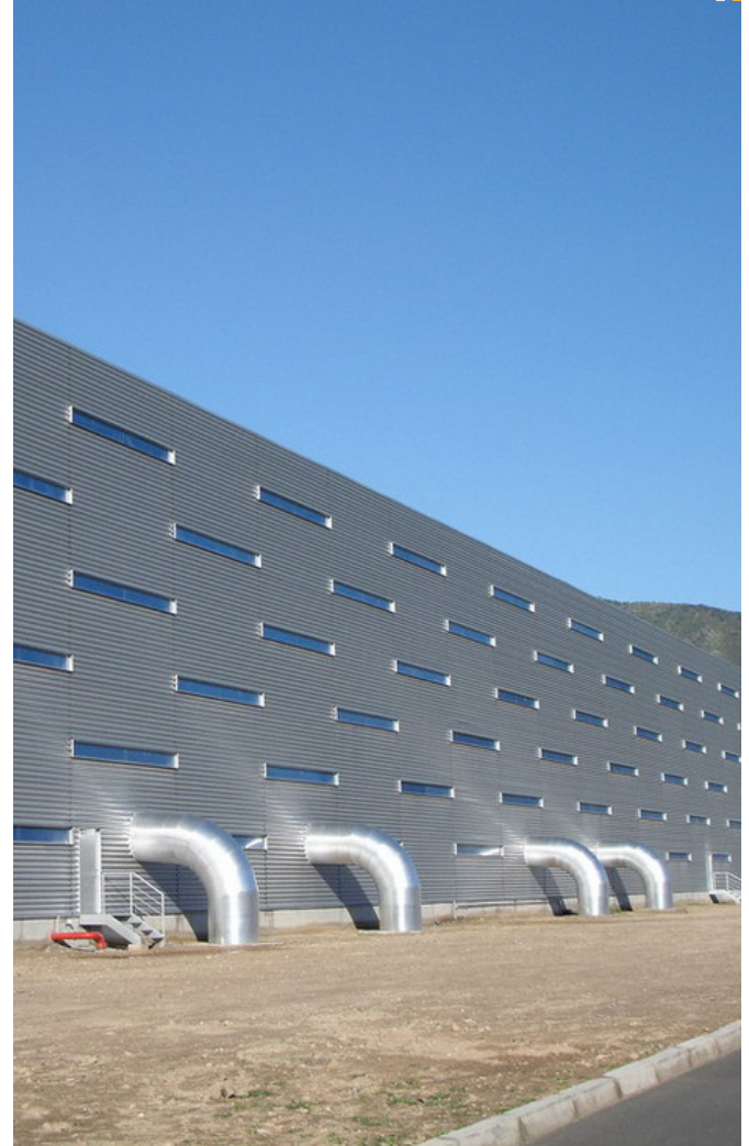
IMAGEN 12. INTERCAMBIADOR DE CALOR GEOTÉRMICO
