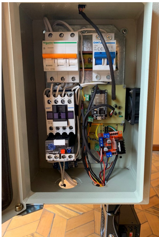
Figura 70. Circuito eléctrico y electrónico instalado
