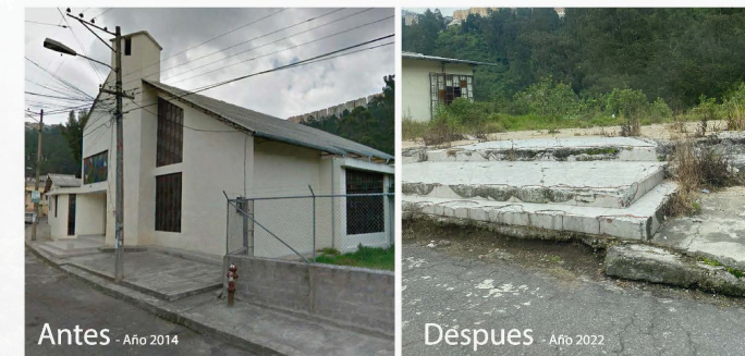
Fig. 03 Colapso de estructuras en el barrio Orquídeas. Fuente: Propia del autor y Google Earth
