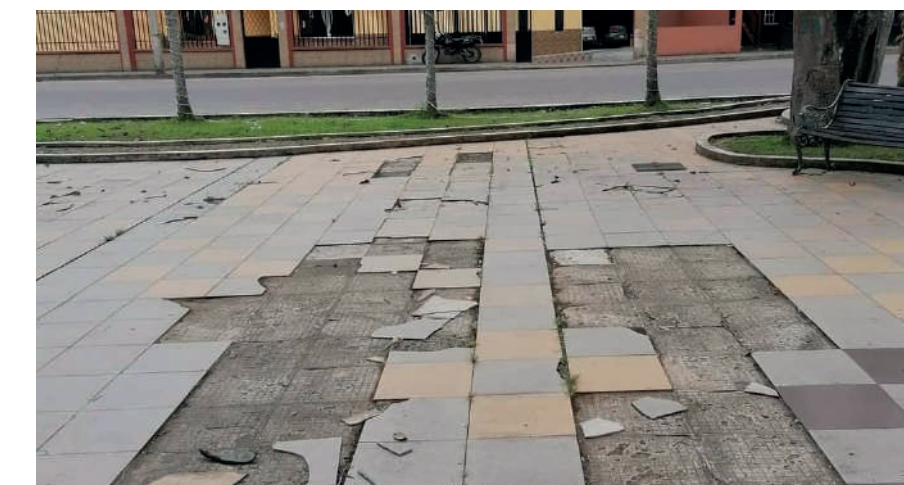
Figura 40. Pisos en mal estado
