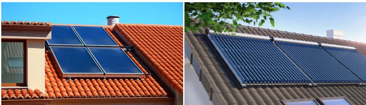
Figura 23: Configuración de captadores placa plana (1) y captadores tipo tubo de vacío (2)
