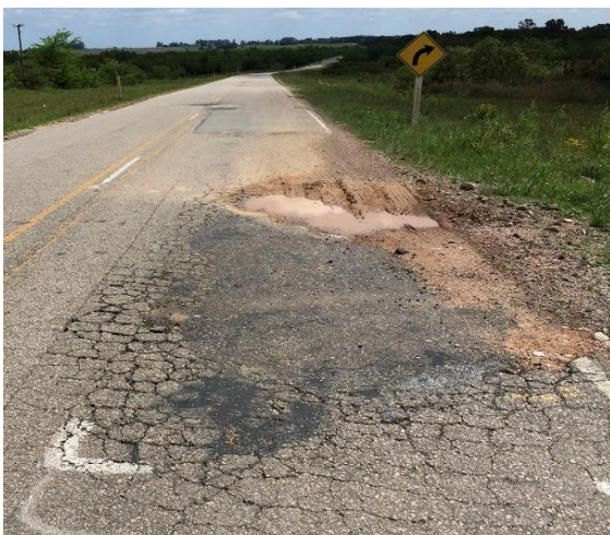
Figura 5.56. Mal estado de la vía (Bifal, 2020)
