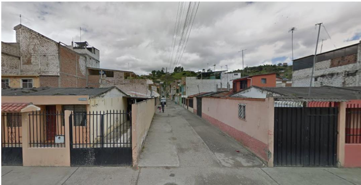
Figura 71. Estado actual de la vía peatonal del barrio Sauces Norte
