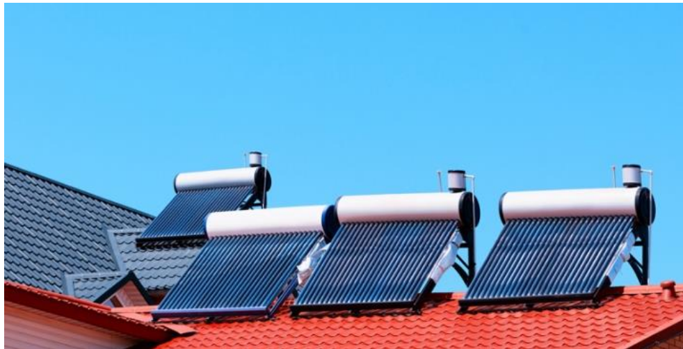
Figura 2.5 Paneles de energía solar térmica
