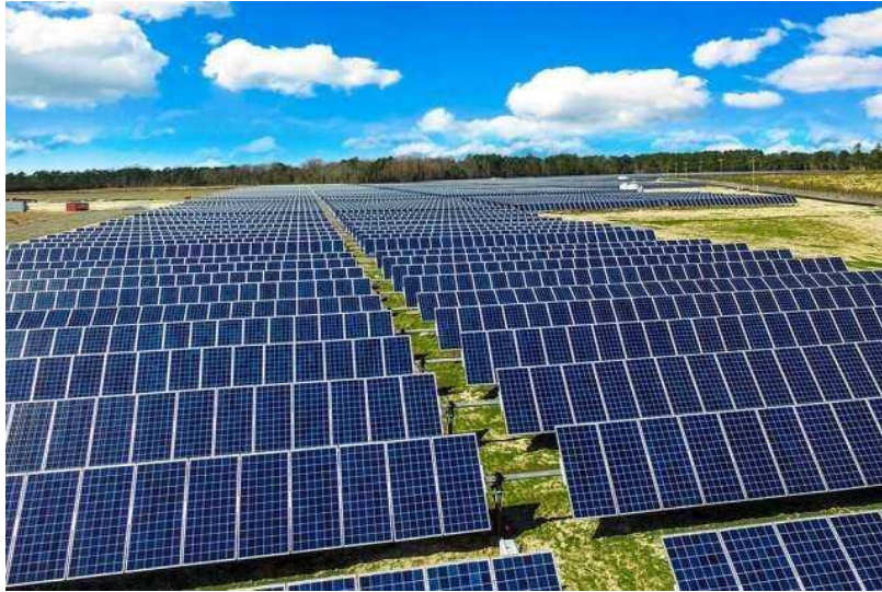
Figura 2.4 Paneles para captar energía solar fotovoltaica
