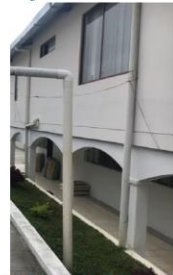
Cables electricos sueltos
