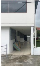
Pasillo sin pasamanos
