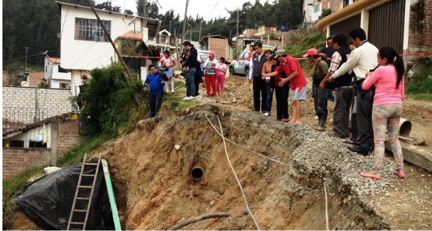
Ilustración 6. Deslizamiento y destrucción de tubería en el sector Tejar de Jericó.
