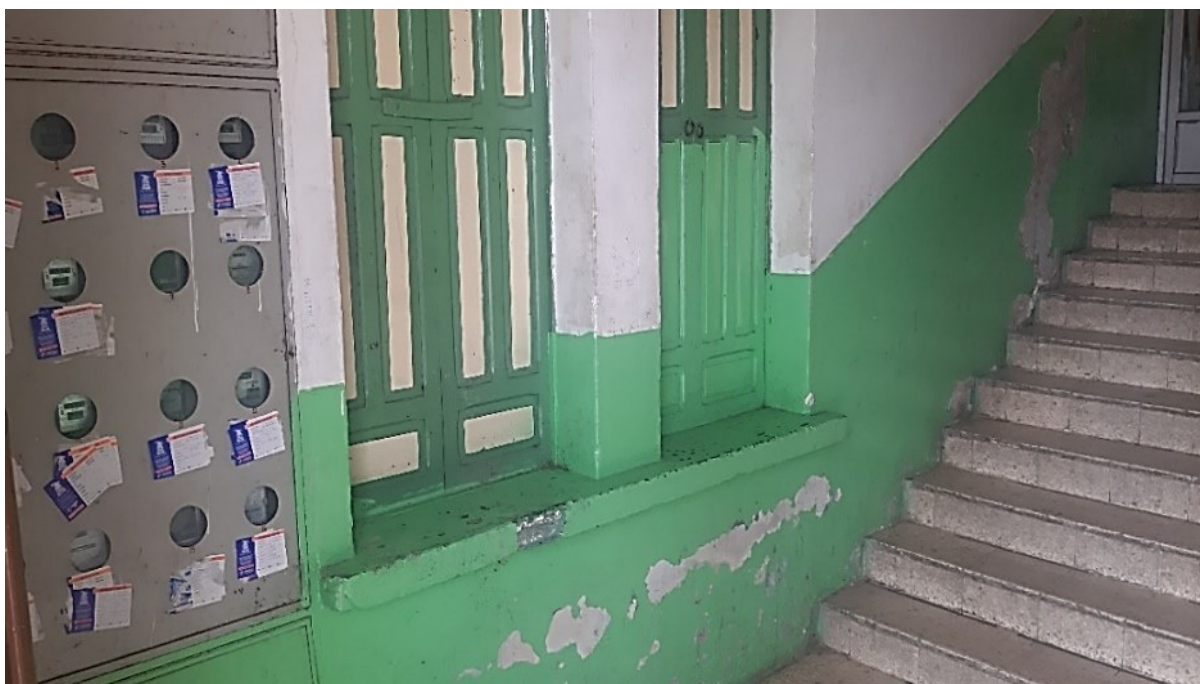
IMAGEN 7: Patología de abombamiento de materiales y de recubrimiento
