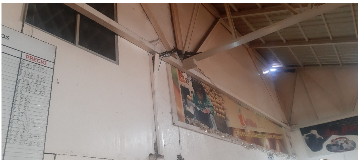
IMAGEN 9: Cables de electricidad expuestos en el espacio interior de la edificación
