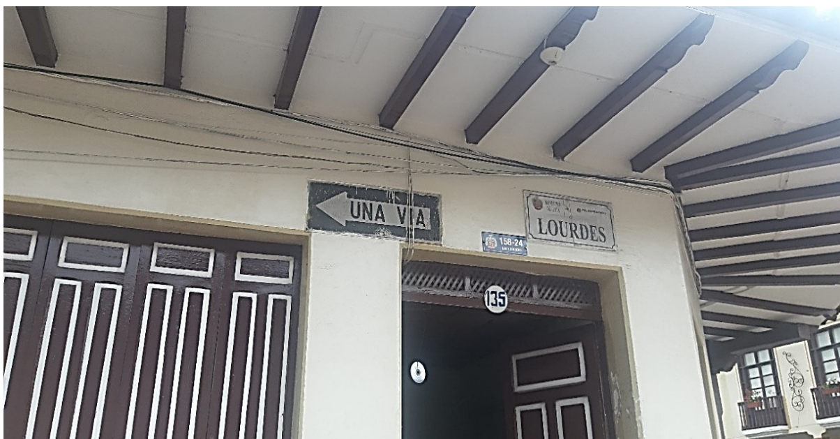
IMAGEN 8: Cables de electricidad expuestos en fachadas
