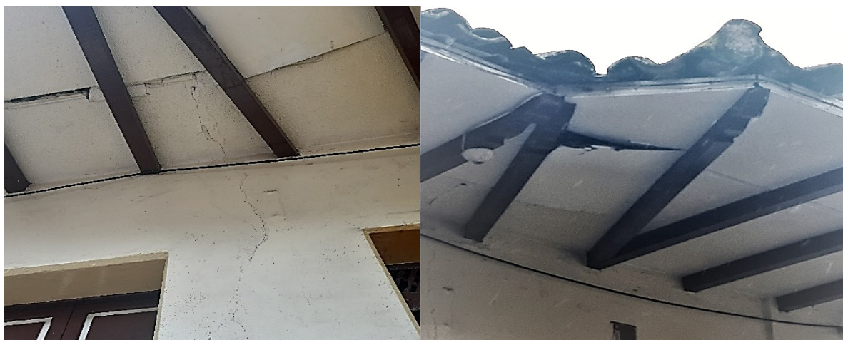
IMAGEN 6: Patología de grietas en los muros portantes y cielo raso
