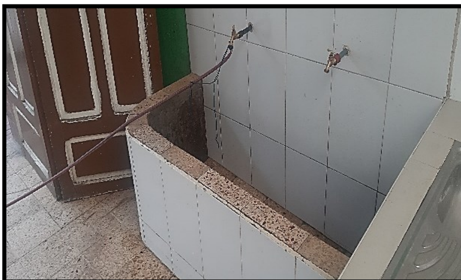
IMAGEN 25: Estado actual de los fregaderos comunales
