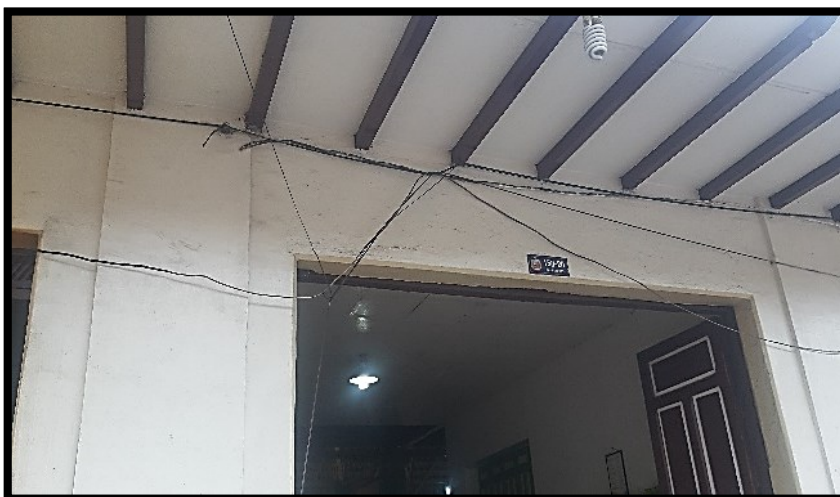
IMAGEN 26: Cableado eléctrico expuesto
