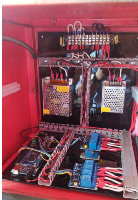
Figura. 4.19. Banco electrónico de control. Ribadeneira, D; Heredia, E; Ríos, B 2020.
