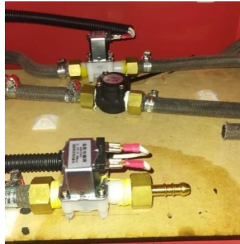
Figura. 4.16. Sensor de flujo y electro válvulas.
