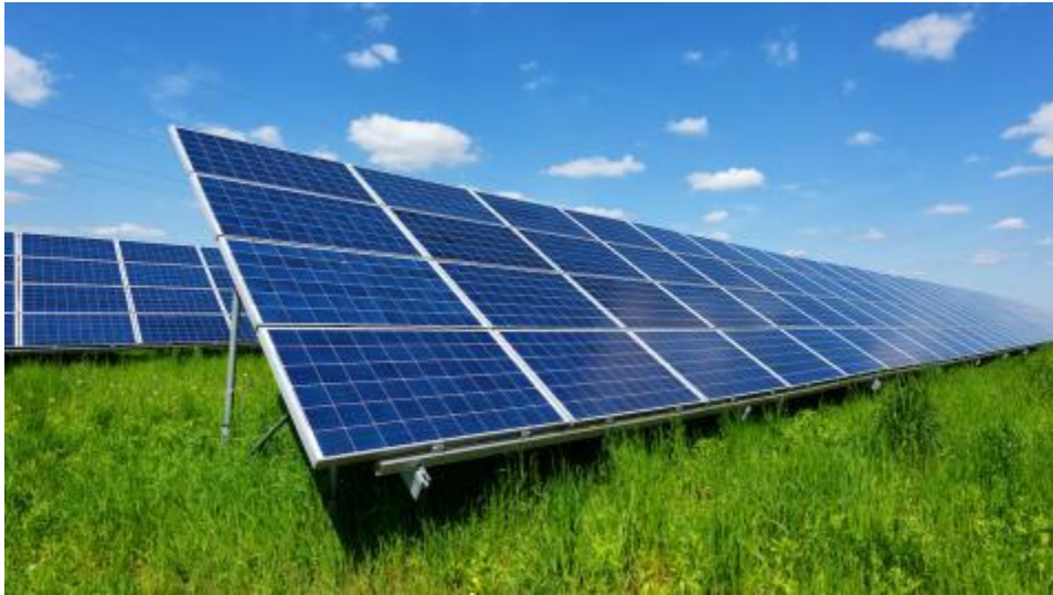
Ilustración 5 Paneles solares instalados
