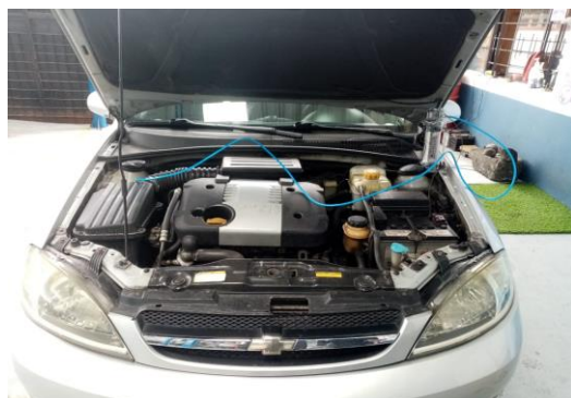
Gráfico 4: Instalación del Generador de hidrógeno Modelo H5, para las pruebas Fuente: Benavides Mayorga
