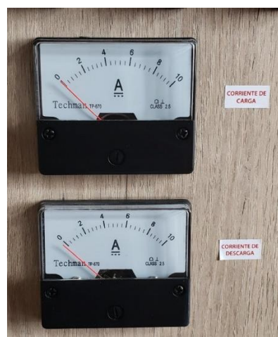
Ilustración 16. Amperímetros de carga y de descarga Tomada por Carlos Álvarez el 16/09/2020
