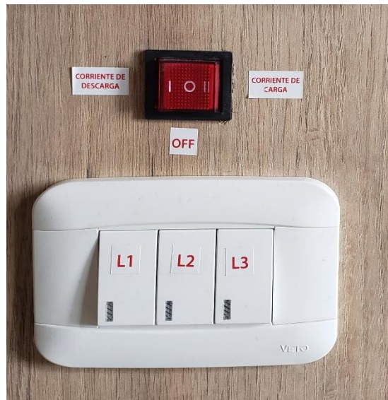
Ilustración 17. Interruptores de encendido de los consumidores para descarga. Tomada por Carlos Álvarez el 16/09/2020
