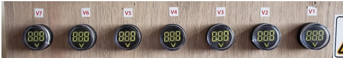
Ilustración 14. Voltímetros de equipo de comprobación de baterías HV. Tomada por Carlos Álvarez el 16/09/2020
