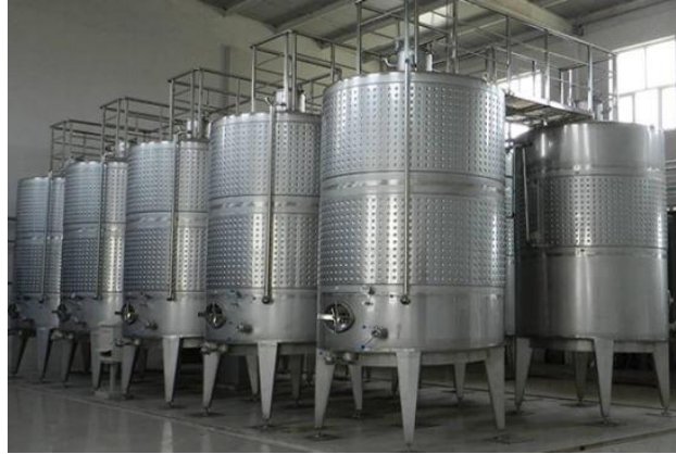
Figura 5. Conjunto de reactores industriales de acero inoxidable
