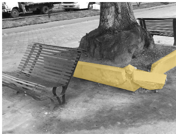
Imagen 2: Afectación de jardineras en parques Elaborado por: Sebastian Sánchez López, 2018.
