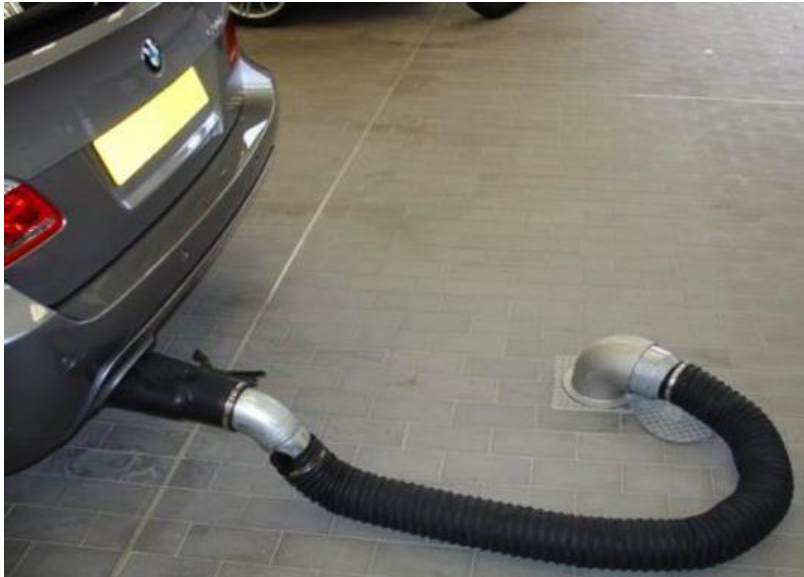
Figura 3. Sistema de extracción de suelo (Nederman, 2019).
