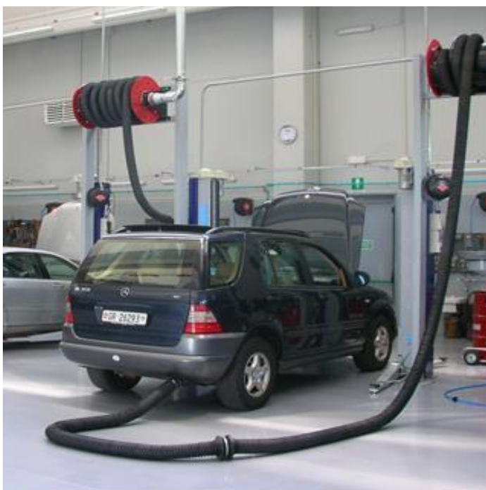
Figura 1. Sistema de extracción de gases de escape (Estrada, 2015).
