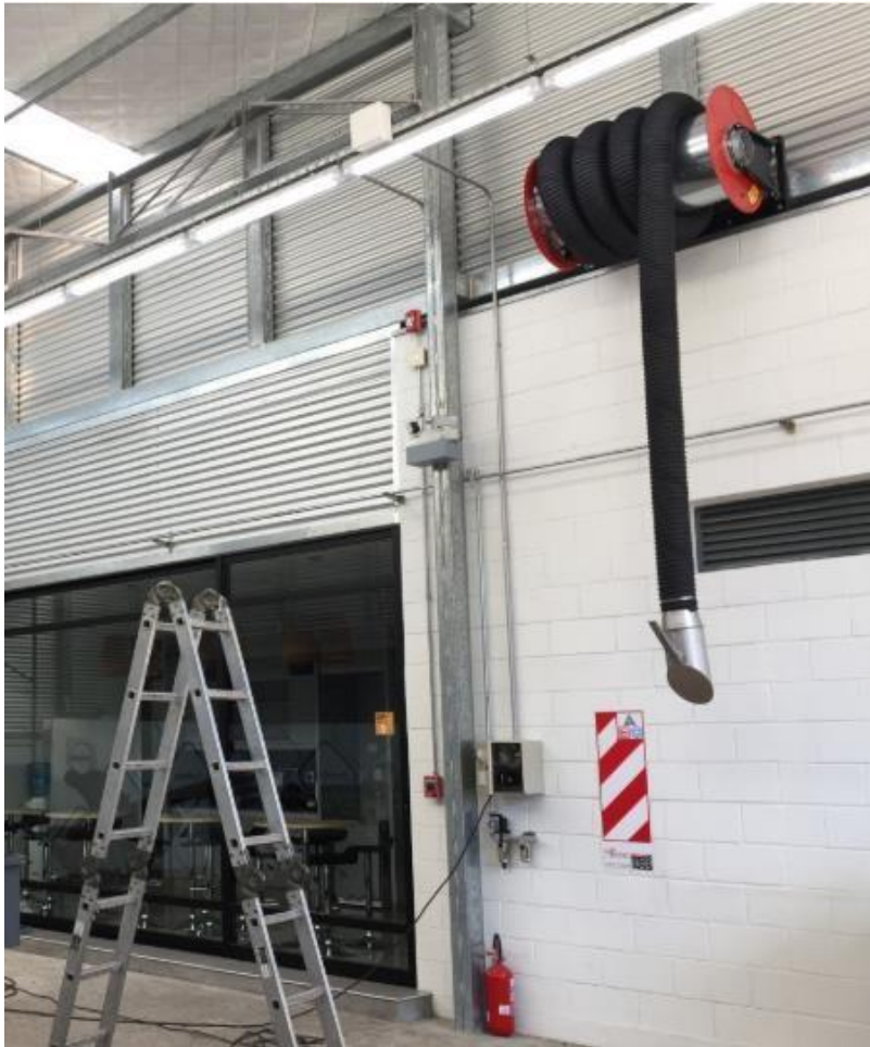
Figura 2. Sistema de extracción aéreo por enrolladores (Nederman, 2019).
