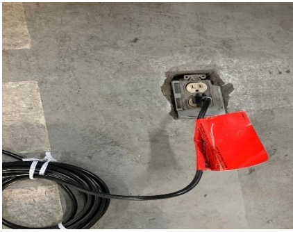
Figura 34. Conexión eléctrica del equipo
