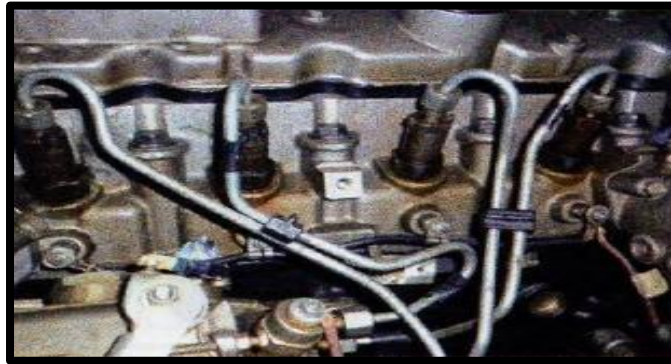
Figura 33. Tuberías de alta presión.(Pérez, 2013)
