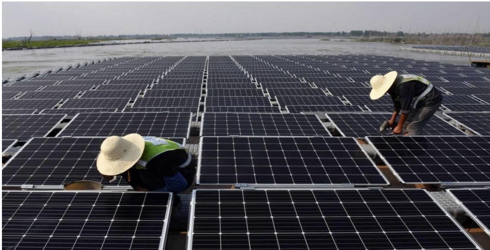
Figura 14. Panel solar o generador fotovoltaico (Macarena, 2017)
