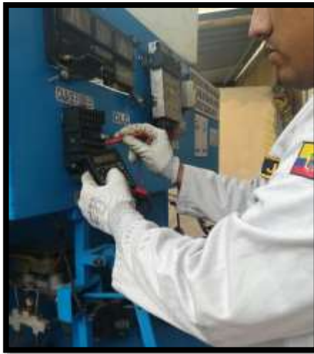
Figura 99. Voltaje en caja de porta fusibles (Tomalá, 2019)
