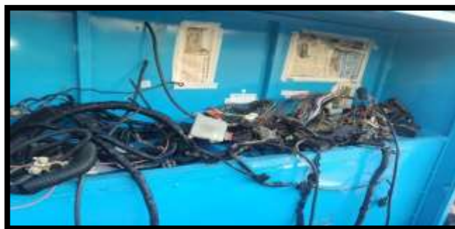
Figura 81. Sistema eléctrico listo para el montaje (Tomalá, 2019)
