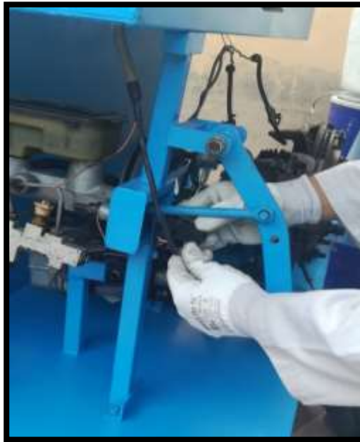
Figura 85. Instalación Interruptor de frenado (Tomalá, 2019)
