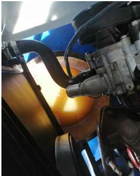
Figura 26 Drenaje del sistema de enfriamiento (Torres, 2019)
