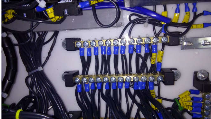
Figura 3.189. Líneas de tierra para conexiones 110 VAC, 24 VDC y – 24 VDC.
