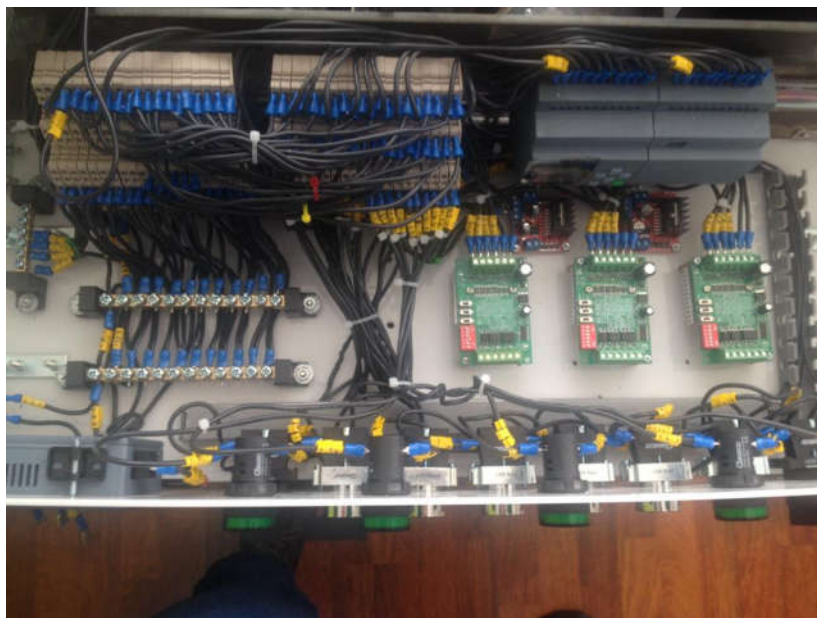
Figura 3.190. Gabinete de control
