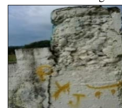
Grietas en muro de graderío
