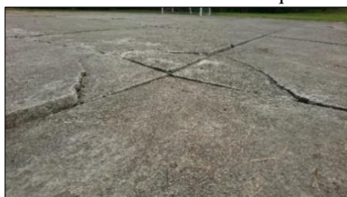
Grietas en la cancha de básquet
