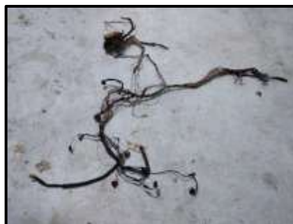
Figura 2.15 Cableado original (Cavadía, 2018)
