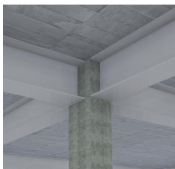
Imagen 44 Hormigón Armado en columna Fuente: Autor
