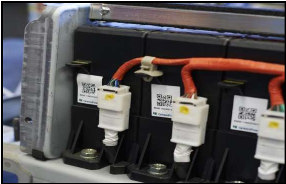
Fig. 30 Módulos de batería híbrida
