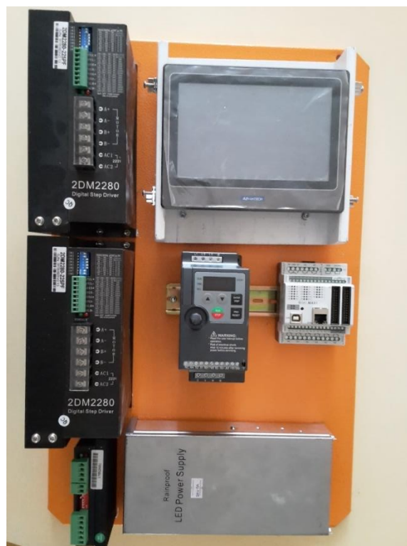
Figura 4.32. Ubicación de elementos en el tablero de control
