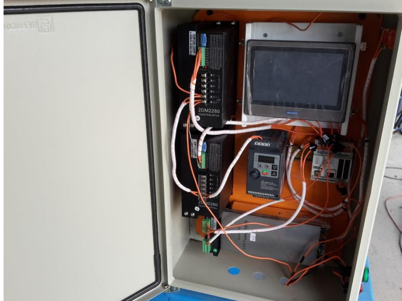
Figura 4.33. Cableado de componentes del gabinete
