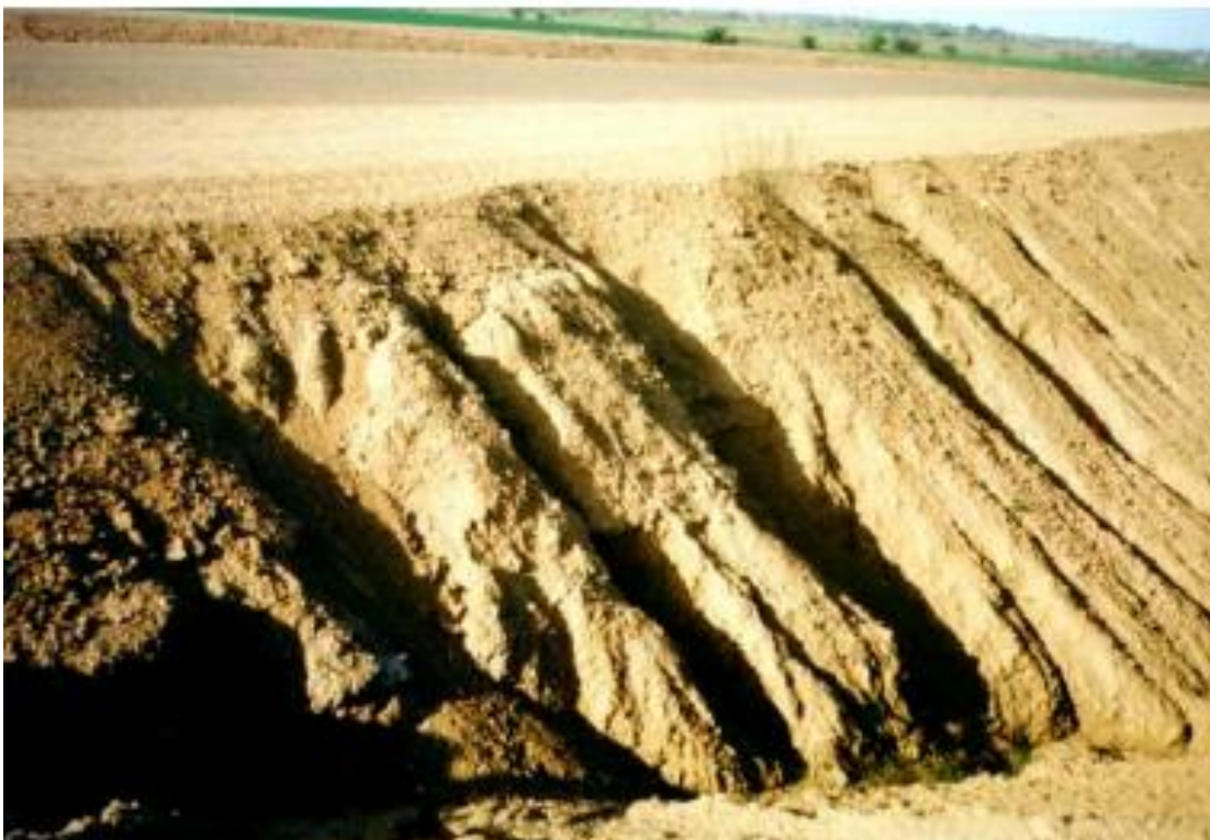
Foto 2. 8: Vista del talud que forma parte de un terraplén
