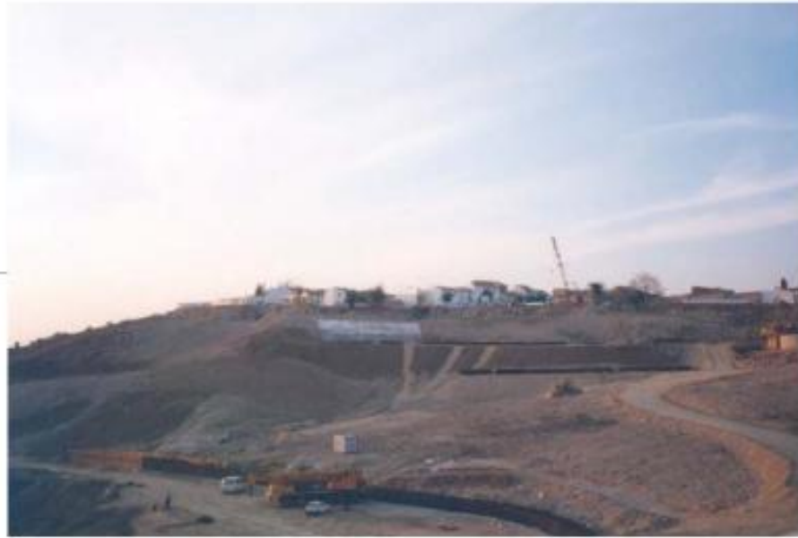
Foto 2. 14: Sistemas de drenaje para evacuar el agua de escorrentía y la existente en la capa freática. Se realizan zanjas de recogida de agua en coronación de talud y en su pie y pozos profundos con conexión horizontal entre ellos en profundidad para aumentar la eficacia del drenaje.
